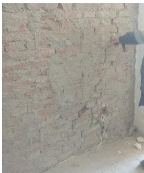
Pukotine širine veće od 10 mm
